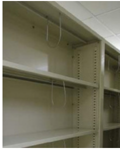
เหล็กกันกันล้ม
